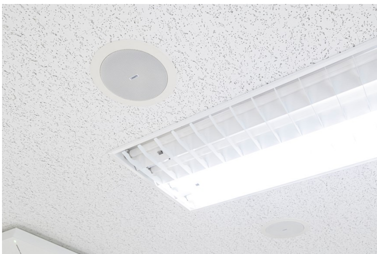
新たに設置された QSC の天井スピーカ ー
