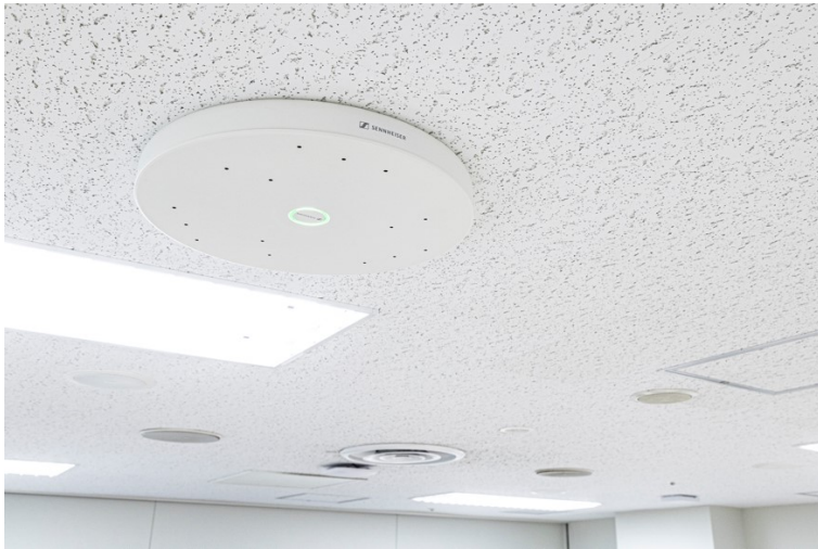
天井に設置された TCC M
