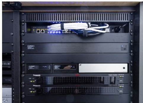
QSC 及び Sennheiser のコントロール機器群
