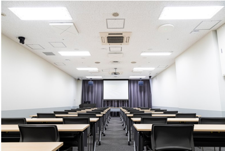
天井に設置された マイクとカメラ
