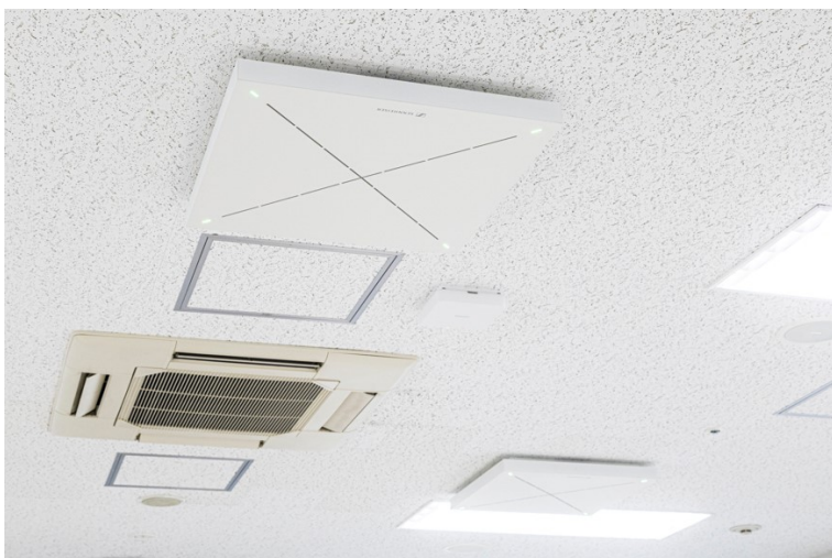
天井に設置された TCC 2
